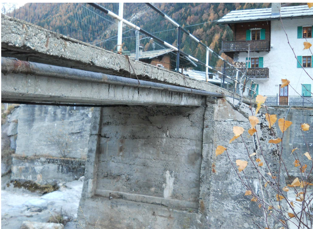
Vista del degrado delle strutture cementizie
